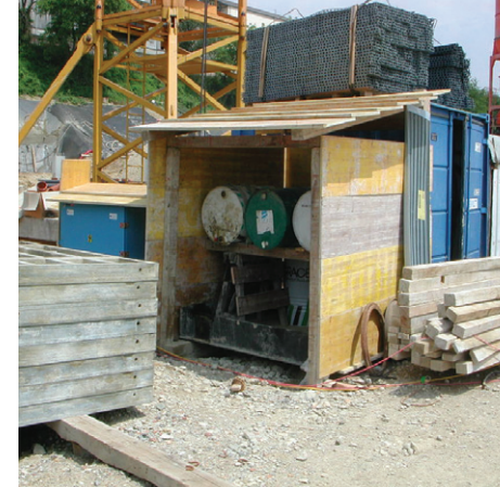
Stockage de fûts d'hydrocarbures sous couvert et sur bac de rétention.
